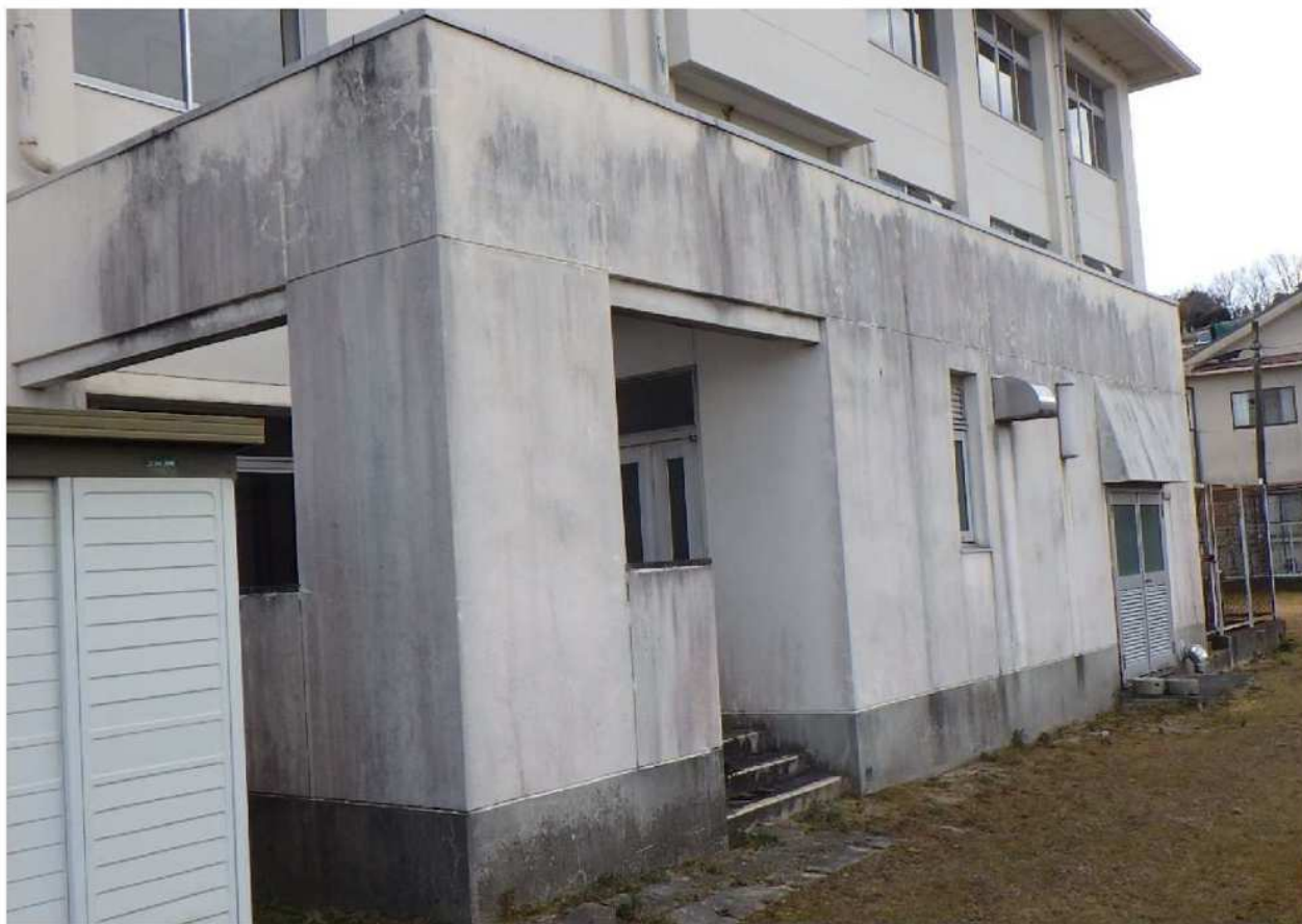
位置番号：⑬ポンプ室・粘土釜室
