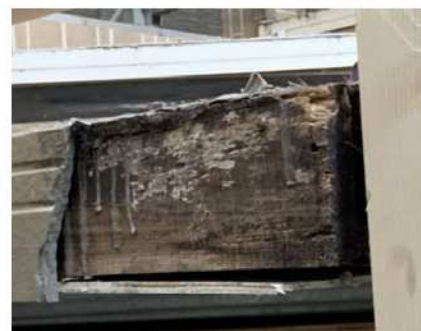
木造階段の外装材料の欠損と木材の腐朽 (出典元：木造の屋外階段等の防腐措置等ガイドライン事例集)
