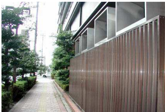
化粧ルーバーにより屋外設備を修景し、街並みに違和感を与えないよう配慮している
