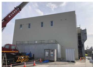
写真2-2-4 白石ポンプ場
