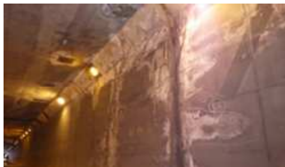
目地部からの漏水跡
