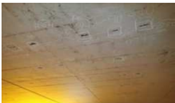
頂版の鉄筋露出
