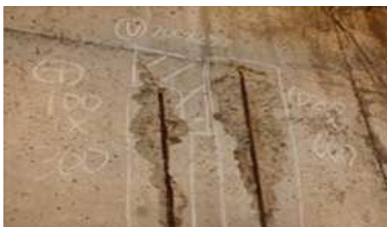
頂版の鉄筋露出
