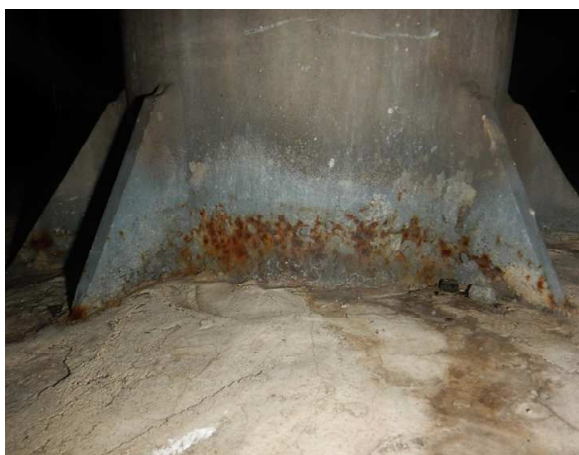
支柱基部の腐食
