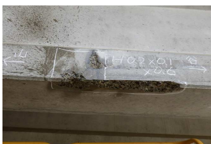
主梁のはく離
