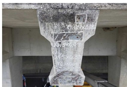
主梁の鋼材露出
