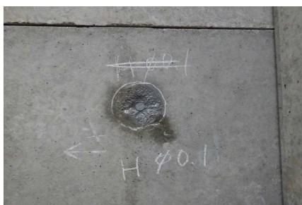
頂版の鉄筋露出
