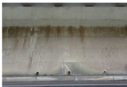
山側受台のひびわれ、遊離石灰
