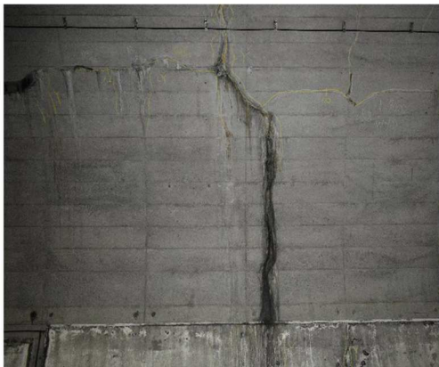
覆工 漏水、遊離石灰
