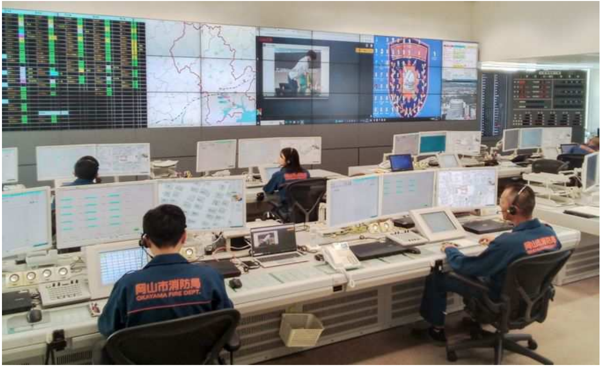
高機能消防指令センター
