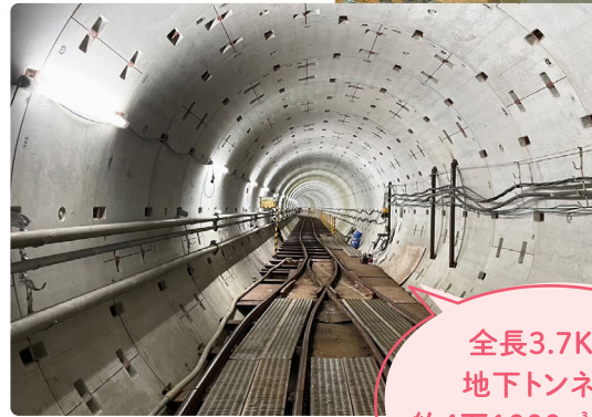
浦安11号幹線(雨水管) 令和6年度末暫定使用
